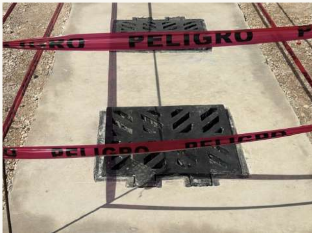
03 • Instalaciones hidrosanitarias y drenaje pluvial
